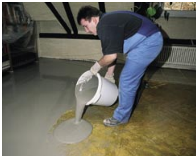
Aplikace Stěrky na dřevěné podklady HSP 34 na dřevěný podklad v tl. min 3 mm.
